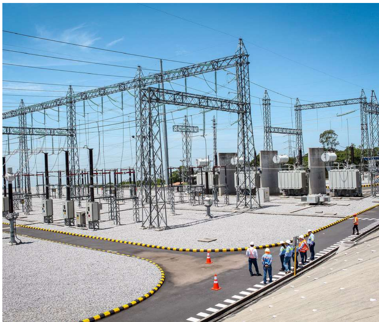
Subestación Palestina 230 kv
