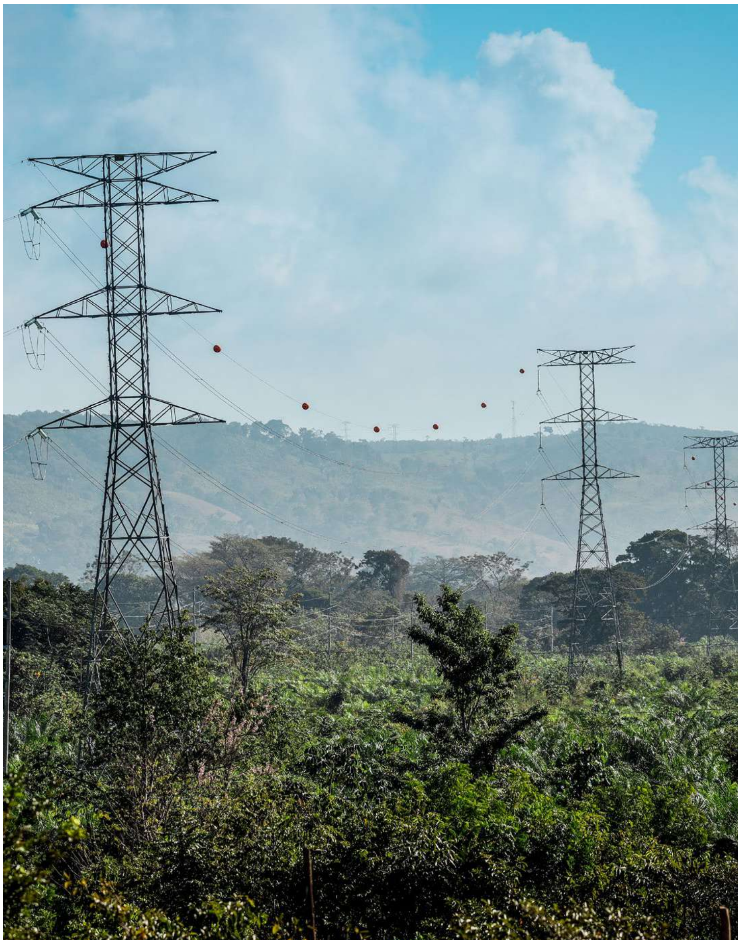
Línea de Transmisión en El Estor, Izabal
